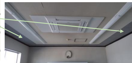
会議室の防音対策
